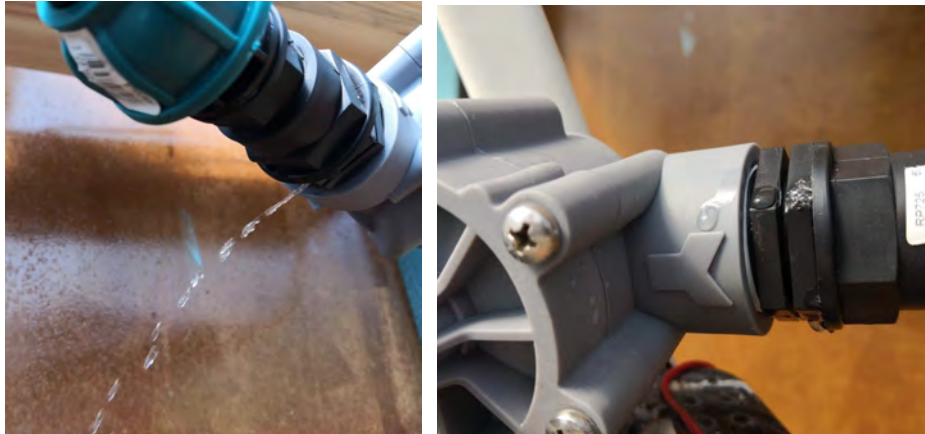
Imatge 3.2.4.5. i 3.2.4.6. - Detecció de fuites.
