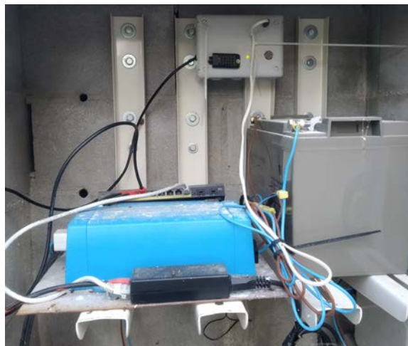
Figure 41. Célula instalada dentro del armario – Fuente: Propia
