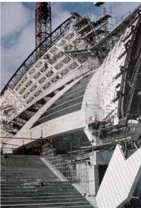
Fig. 3: Proceso de obra de la Ópera de Sídney, en la que participaron Ove Arup y Peter Rice
