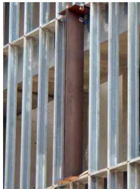
Fig. 2: El muro descompuesto es un claro ejemplo del engaño visual. Cada uno de los elementos pierde espesor a medida que se aproxima a la línea de fachada para el ojo perciba el espesor de la pieza como esa primera línea
