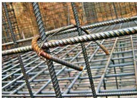
Fig. 5: Armaduras que asumimos que están ahí, pudiendo intuir su posición
