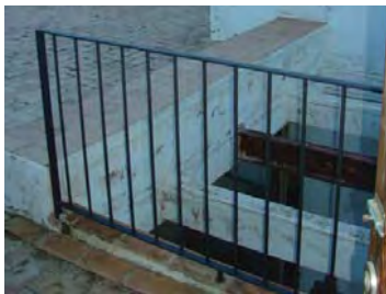
95. Baranda, estado anterior.
