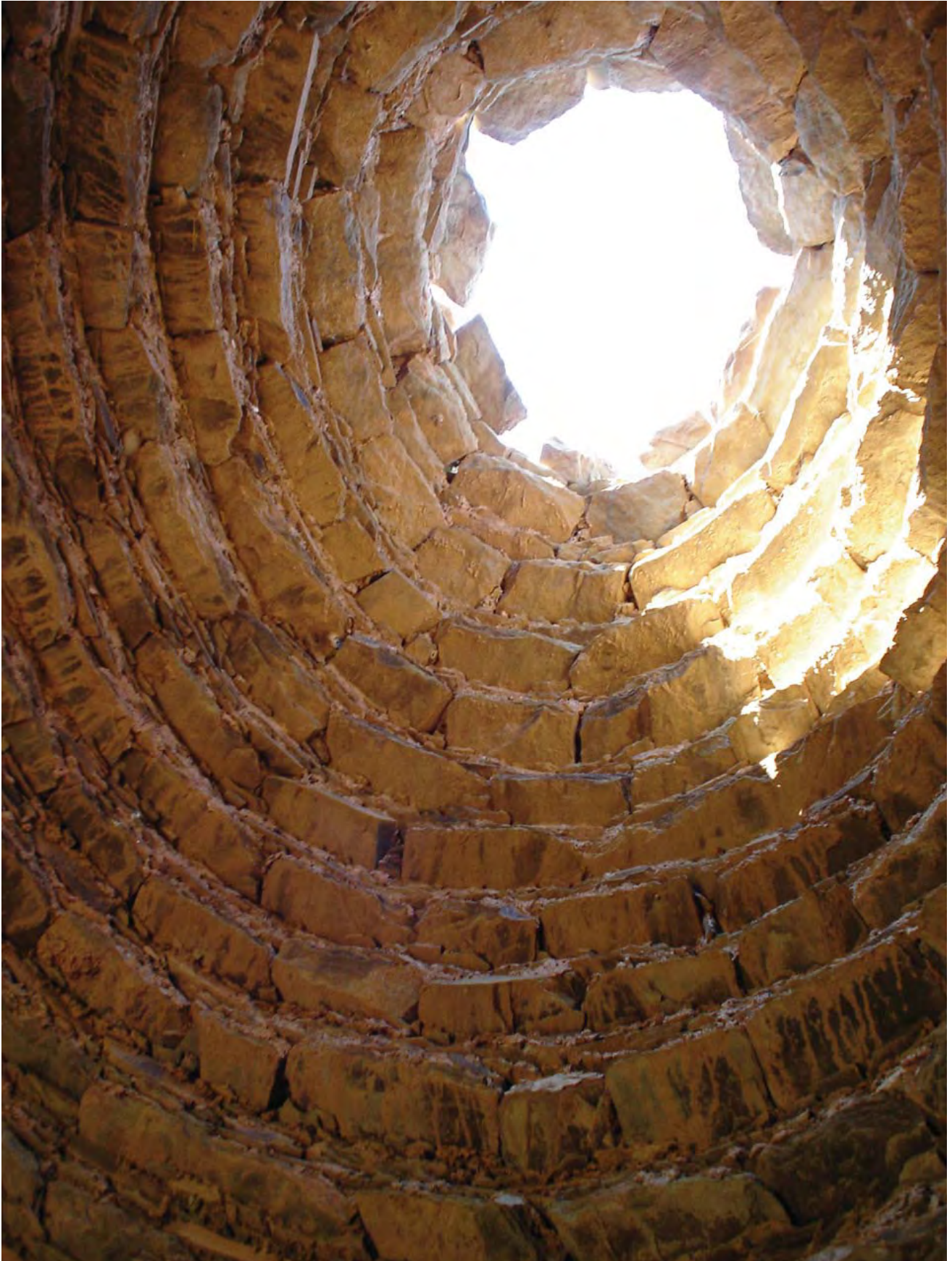
Cubierta de una vivienda tradicional española. Domo hecho en piedra con apertura superior para dejar salir el humo de la hoguera.
