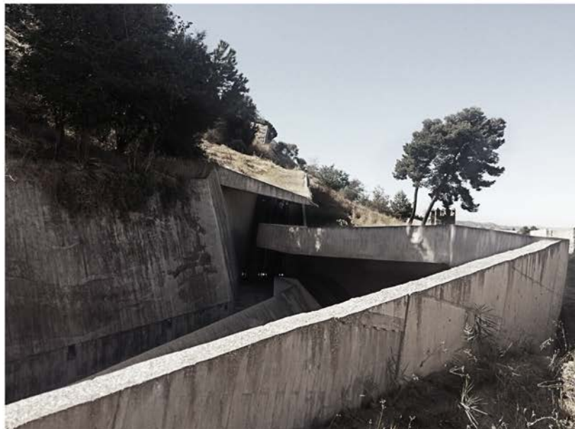
Superposición de planos. Vista desde el acceso inferior de la subida de la Granja.
