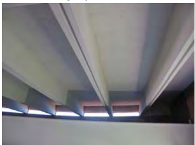
Fig 135. RV. Cubierta Recepción. Viga de hormigón con rehundido central
